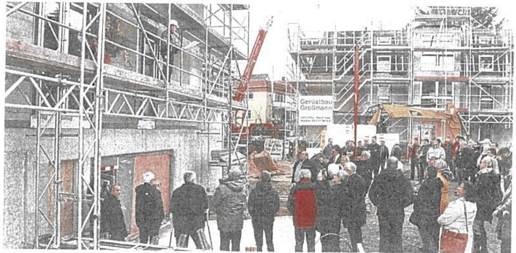
Polier Erich Pimpl (auf dem Gerüst) verliest den Richtspruch für die Mehrfamilienhäuser in der Londorfer Straße.
